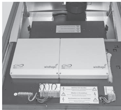
Fig. 76 Modules fonctionnels (système de régulation MES INFINITY) montés sur le tableau de distribution de la chaudière
