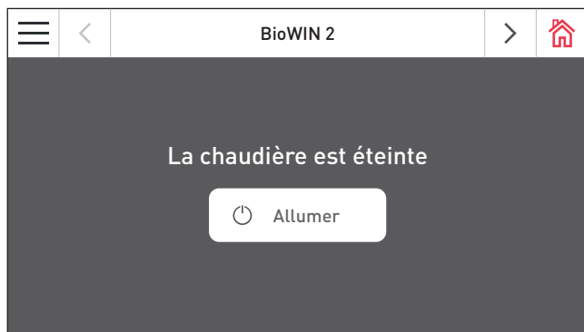
Fig. 54 La chaudière est éteinte
