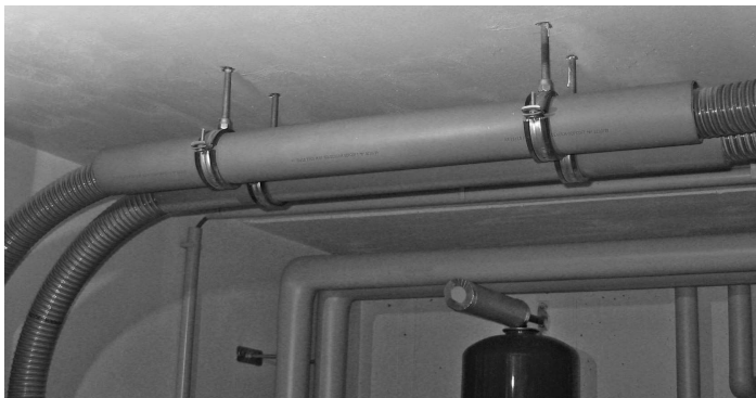
Fig. 7 Tuyaux d'alimentation dans les tuyaux Polokal
